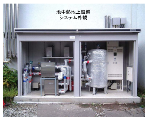
図 11 地中熱設備。向かって左側にあるのがジオヒートポンプ。右側がバッファータンク
